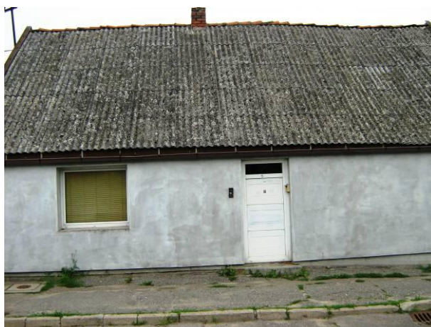
Rys. 7. Pokrycie dachowe ocenione w II stopniu pilności.
