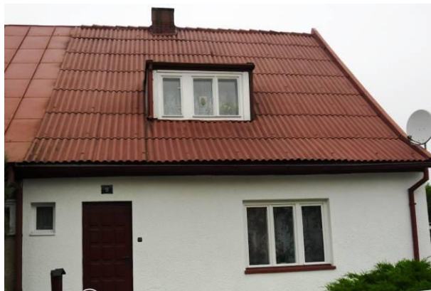
Rys. 6. Pokrycie dachowe ocenione w III stopniu pilności.
