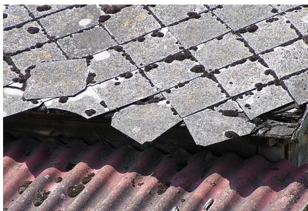
Rys. 8. Pokrycie dachowe ocenione w I stopniu pilności.
