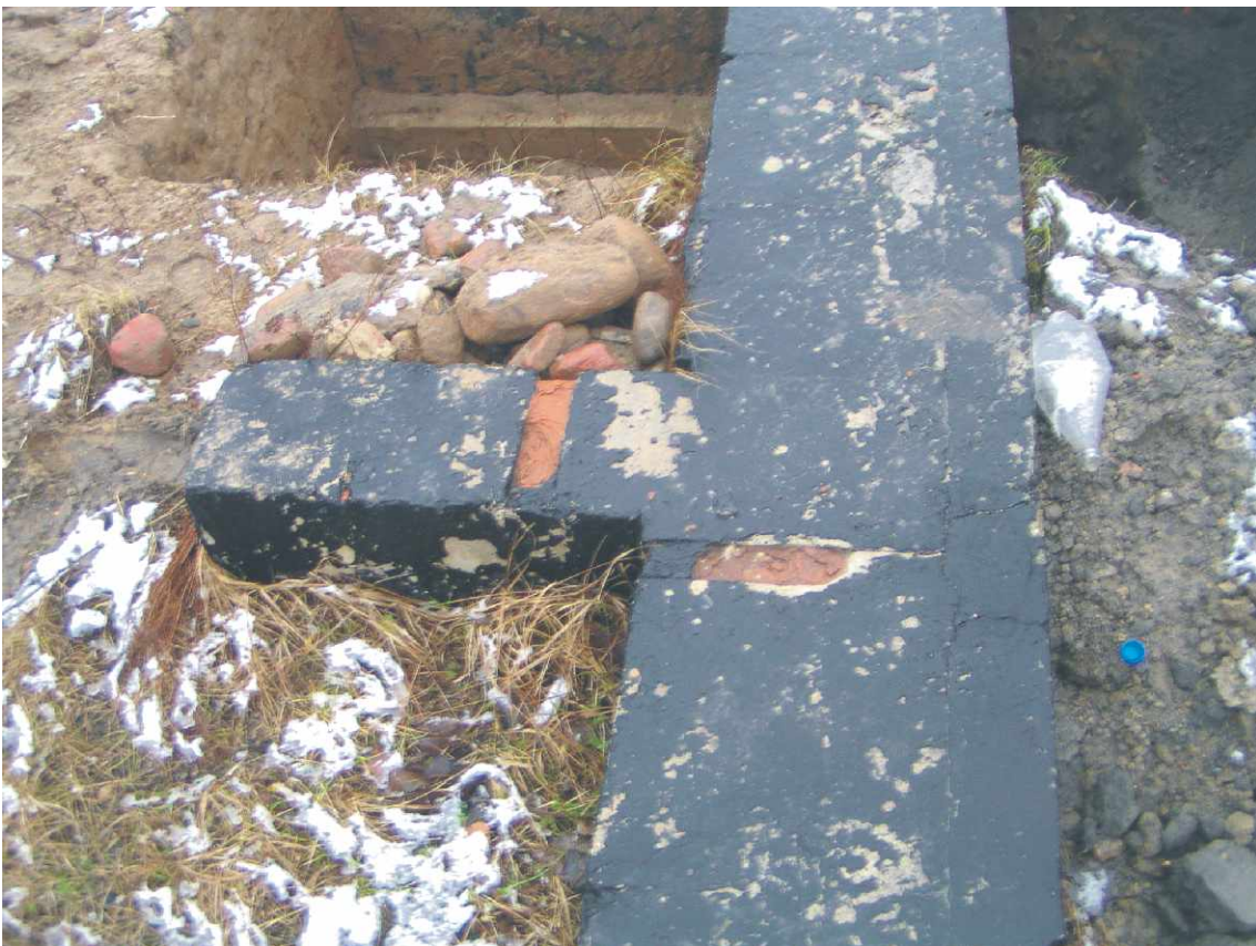
Fot. nr 46. Uszkodzenia i fragmenty z cegły - miejsce wykonania patrz rys. nr 1.
