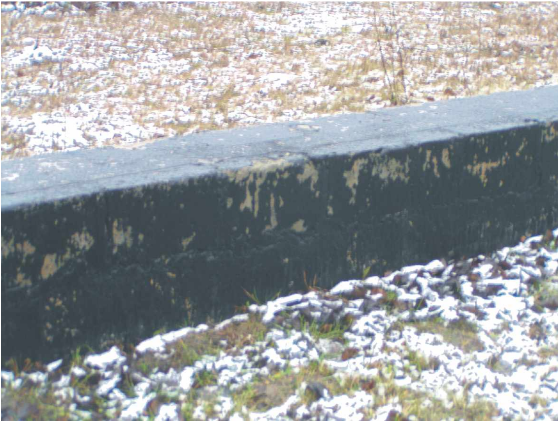
Fot. nr 43. Uszkodzenia ściany fundamentowej, widoczne zarysowanie z bloczków betonowych - miejsce wykonania patrz rys. nr 1.
