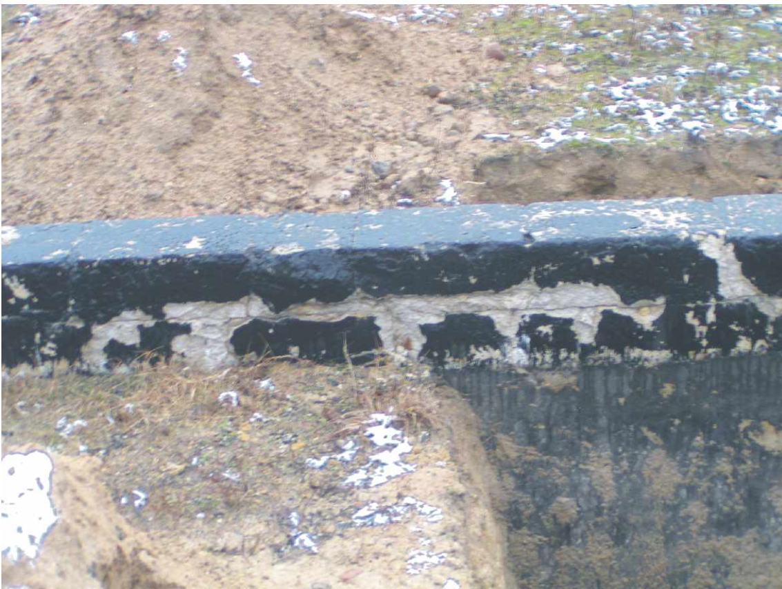
Fot. nr 42. Uszkodzenia ściany fundamentowej - miejsce wykonania patrz rys. nr 1.
