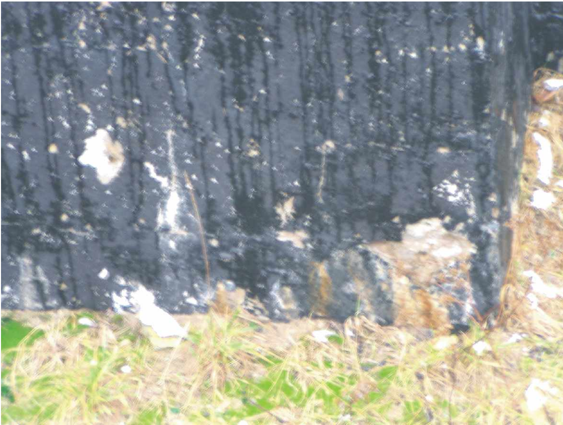
Fot. nr 45. Uszkodzenia ściany fundamentowej, widoczne zarysowanie z bloczków betonowych - miejsce wykonania patrz rys. nr 1.
