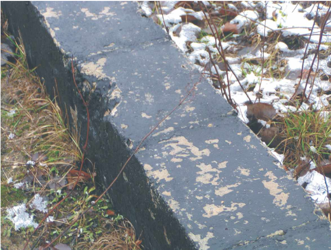
Fot. nr 39. Uszkodzenia ściany fundamentowej - miejsce wykonania patrz rys. nr 1.
