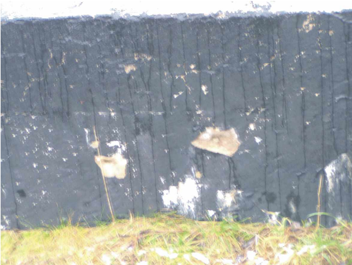
Fot. nr 41. Uszkodzenia ściany fundamentowej - miejsce wykonania patrz rys. nr 1.
