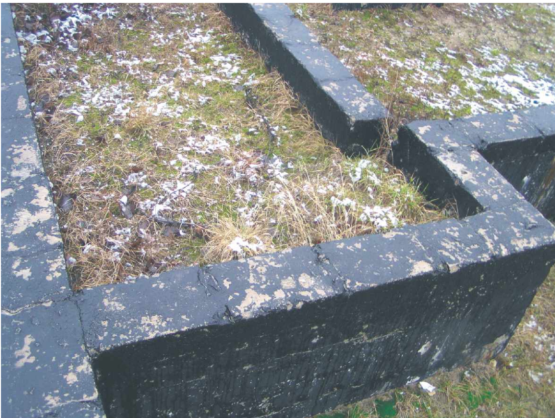
Fot. nr 40. Uszkodzenia ściany fundamentowej - miejsce wykonania patrz rys. nr 1.
