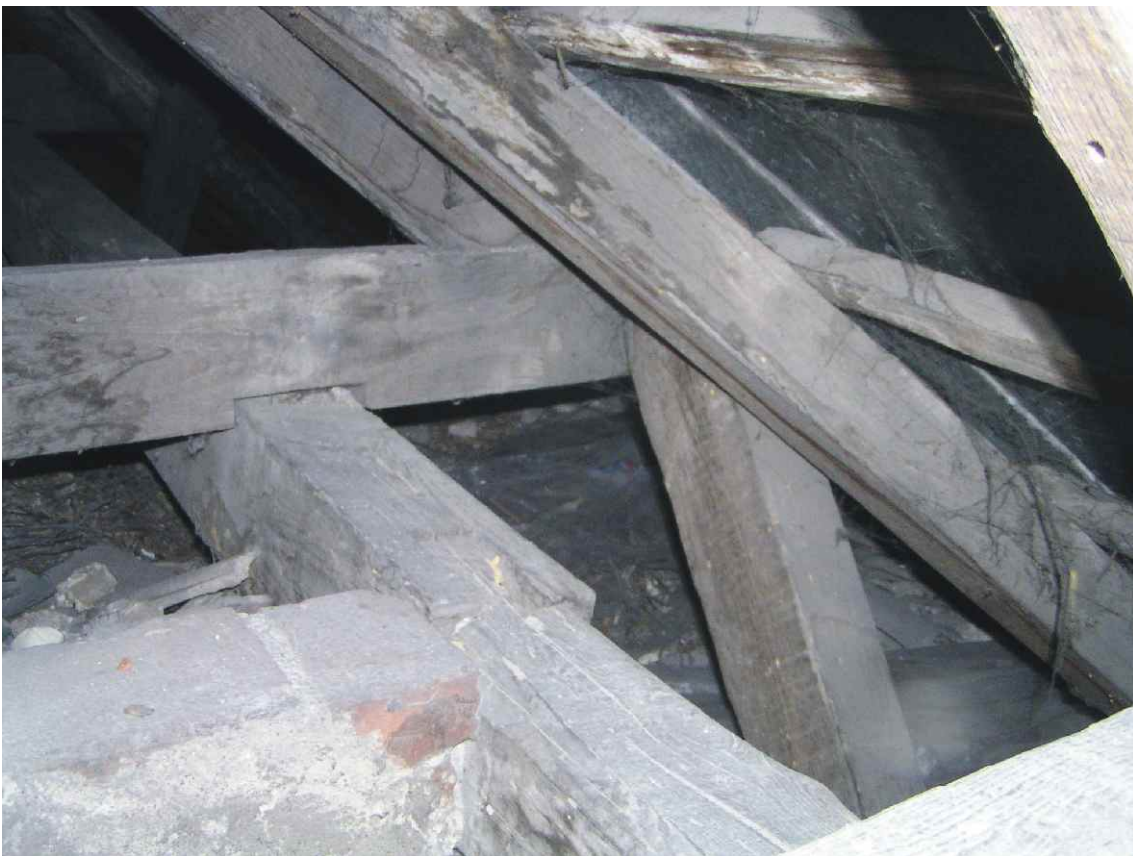
Fot. nr 56. Fragment wieżby dachowej - korozja biologiczna.
