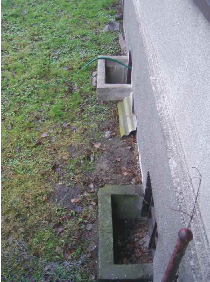
Fot. nr 21. Studzienki okien piwnicznych.
