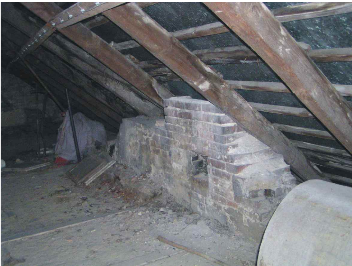
Fot. nr 52. Zamurowany komin na poddaszu.
