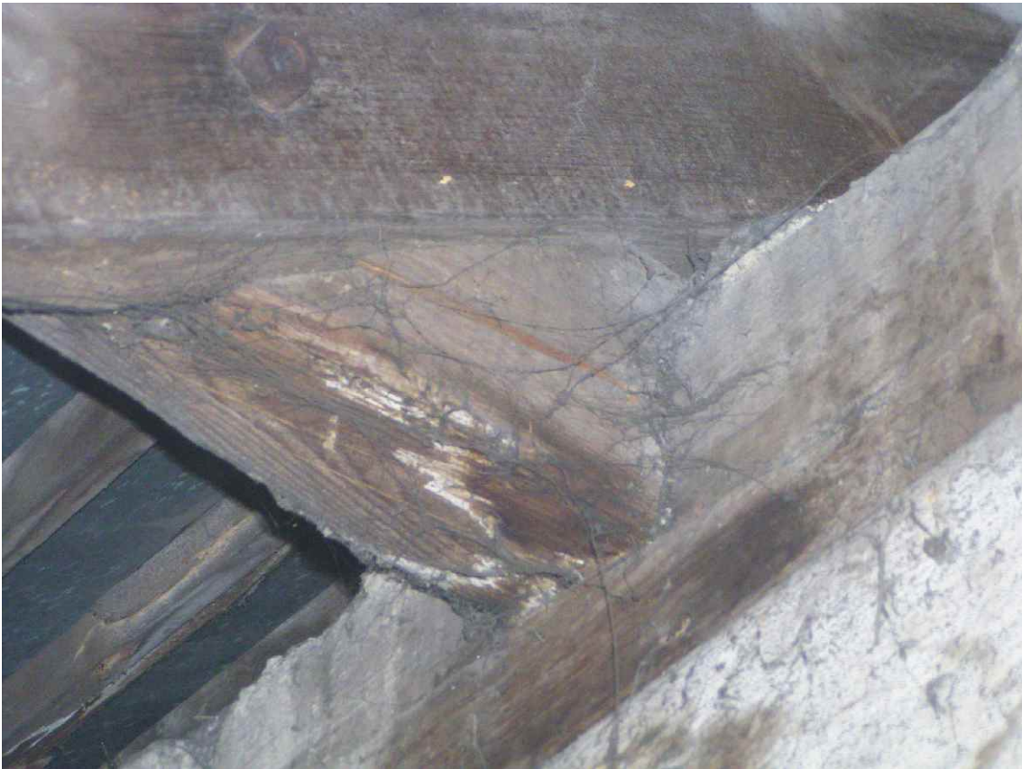
Fot. nr 31. Fragment połączeń jętka, krokiew, płatew - korozja biologiczna.
