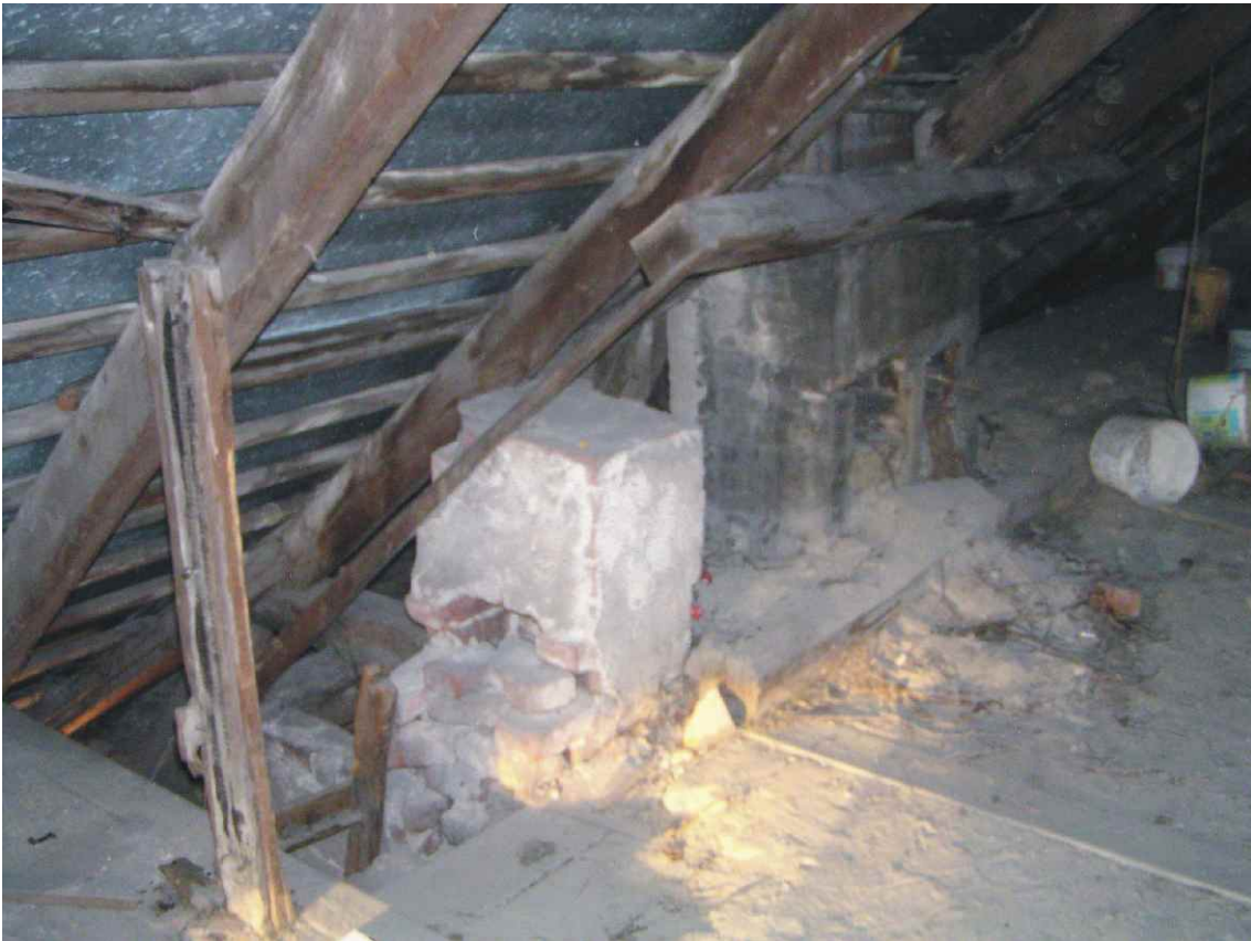
Fot. nr 53. Zamurowany komin na poddaszu.
