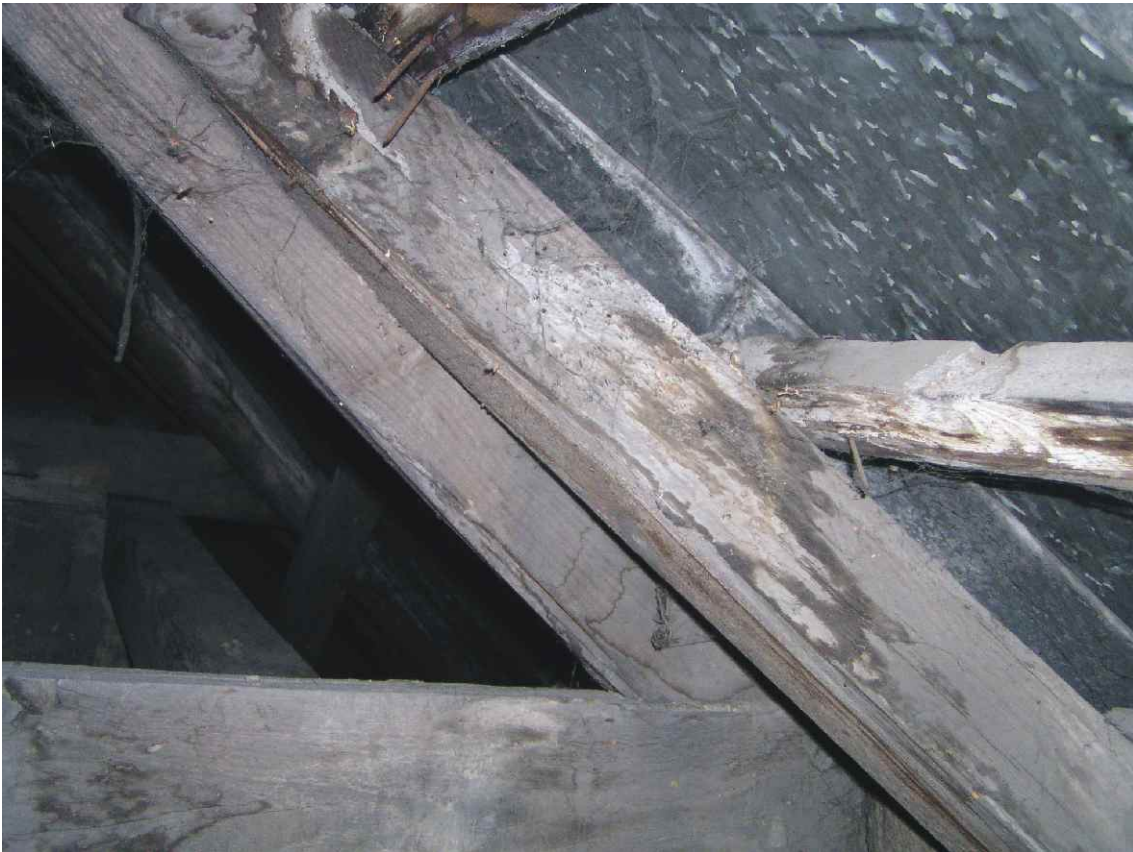
Fot. nr 57. Korozja biologiczna elementów drewnianych.
