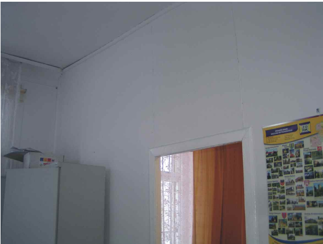
Fot. nr 40. Pokój biurowy - zacieki.
