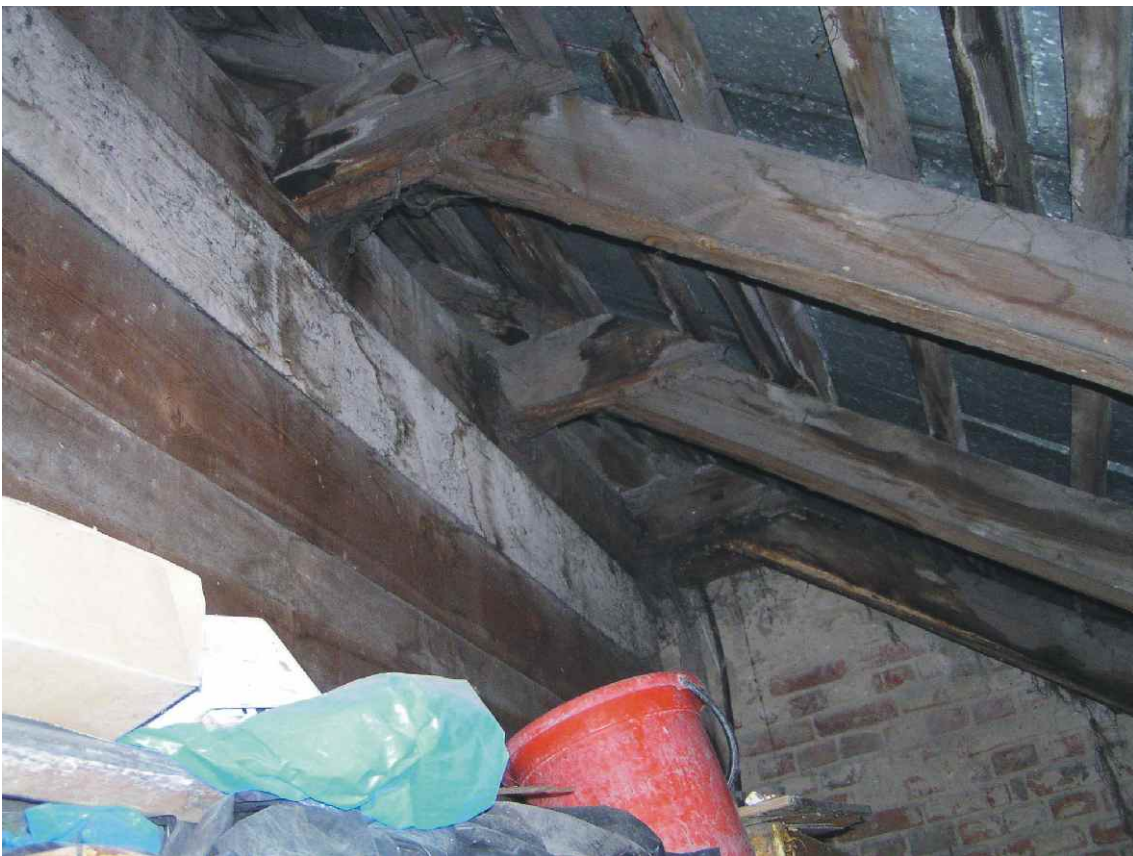
Fot. nr 60. Fragment wieżby dachowej - korozja biologiczna.
