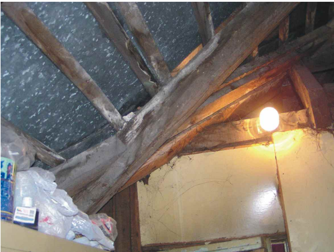
Fot. nr 62. Fragment poddasza - korozja biologiczna.
