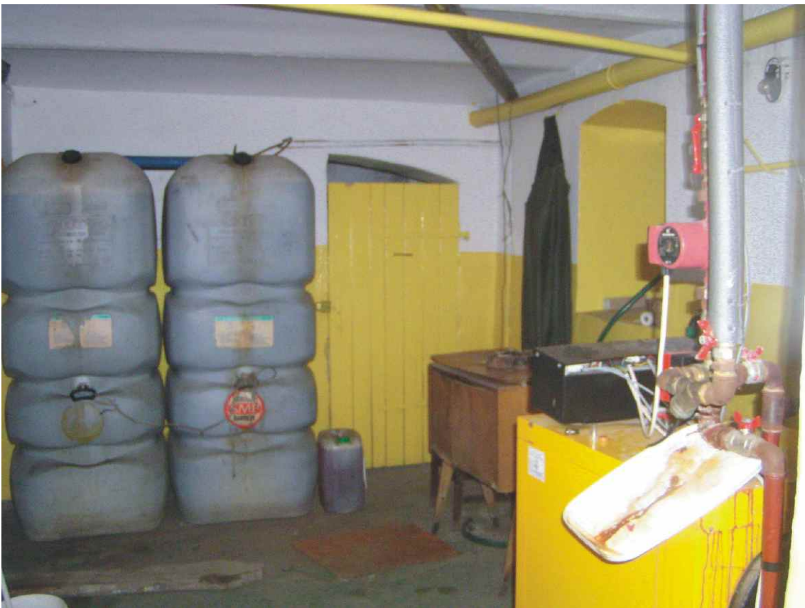
Fot. nr 46. Kotłownia.
