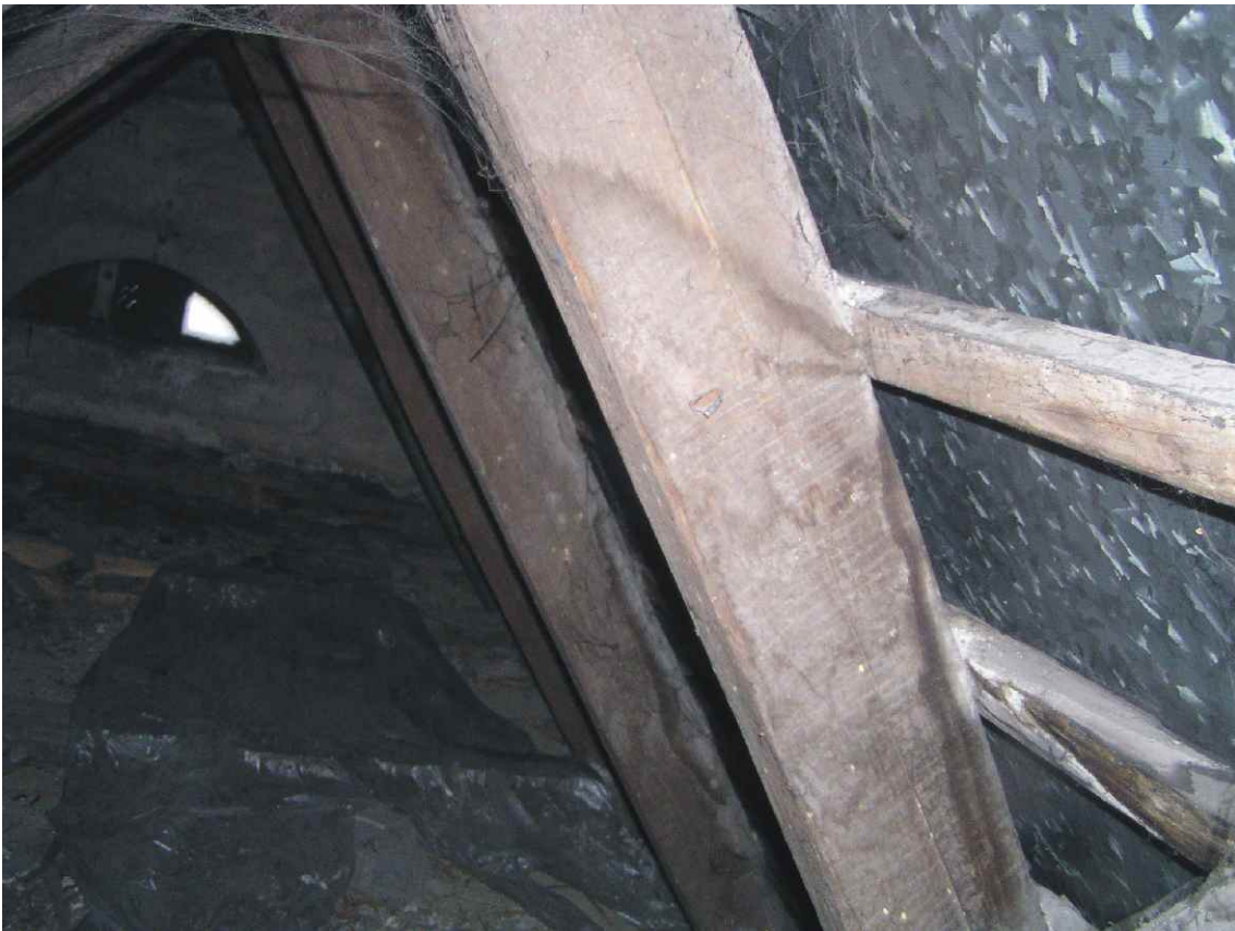
Fot. nr 54. Korozja biologiczna krokwi - larwy owadów (otwory).
